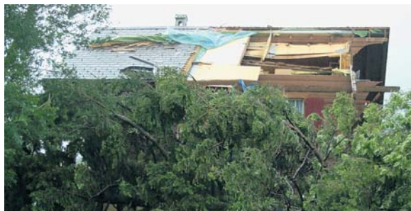
Bäume wie Zündhölzer geknickt: Einer der Lido-Bäume riss in Brunnen das Chalet-Dach weg.
